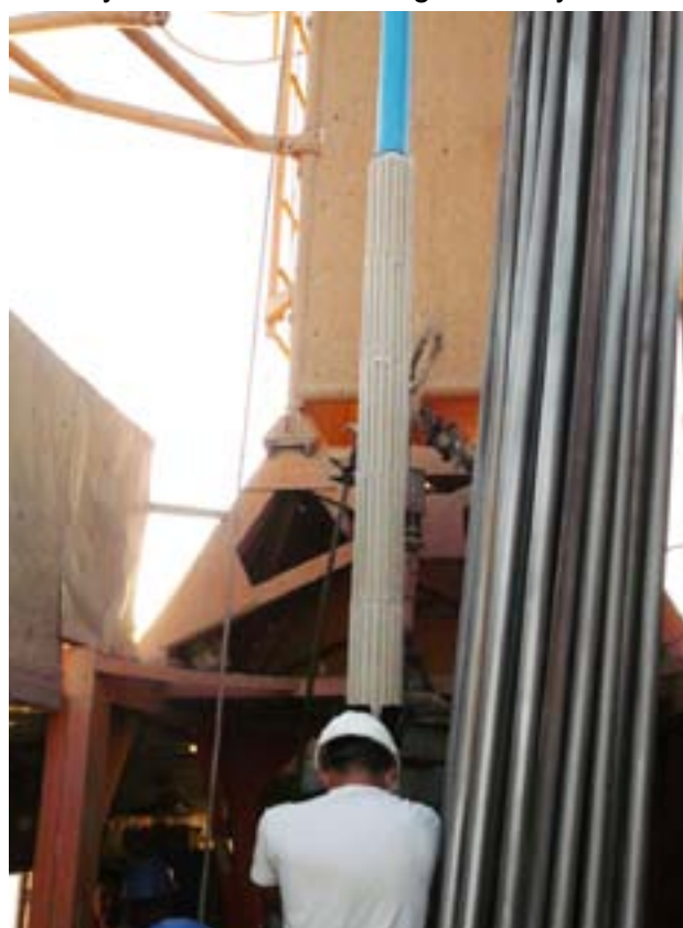
Рисунок 4. Спуск обсадной колонны с набором бентонитовых гильз в скважину Figure 4. Loading the casing column with bentonite sleeves into the well
